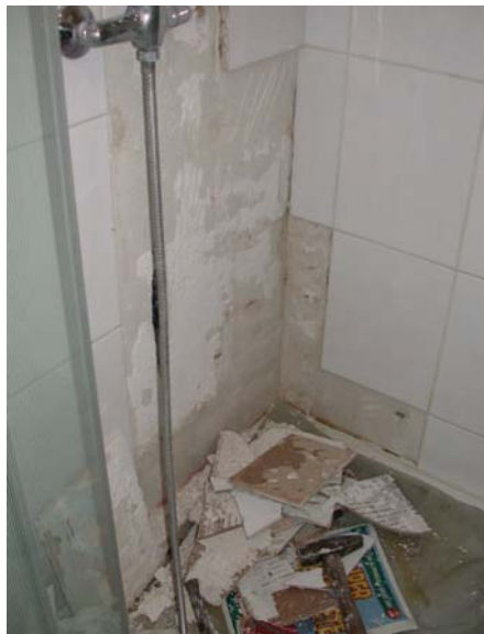
Afb. 1 Loskomen van de muurbetegeling in een doucheruimte.
