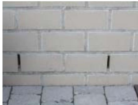
Afb. 2 Onvoldoende geopende stootvoegen.
