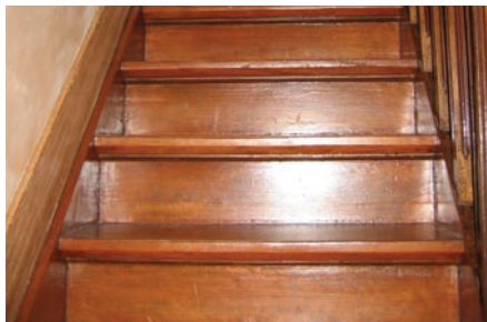
Een houten trap moet ook na een brand zijn functie blijven vervullen.
