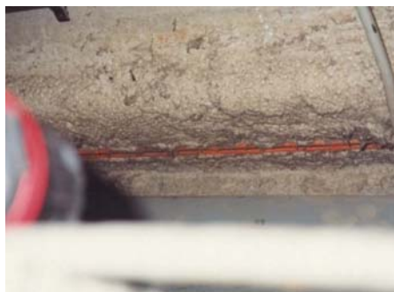
Afb. 1 Plafond met spuitasbest.
